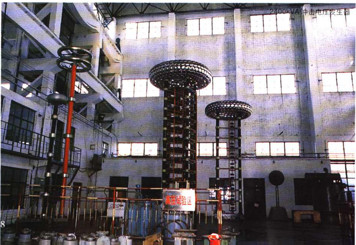
500kV 变压器现场电气试验
