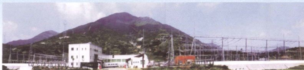
500千伏莆田变电站(主变压器1台，容量75万千伏安。 2000年3月投运)
