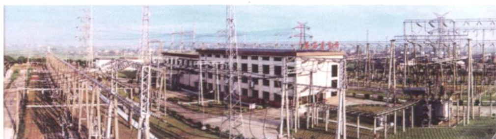
220千伏笏石变电站(主变压器2台，容量36万千伏安。 1988年第一台主变压器投运,1997年第二台主变压器投运)。该 站是莆田市第一座220千伏变电站
