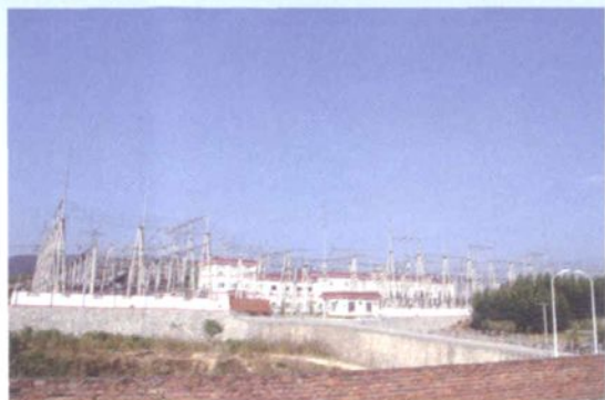
220千伏盖尾变电站(主变压器1台, 容量18万千伏安。2006年1月投运)。该站是莆田市第四座220千伏变电站
