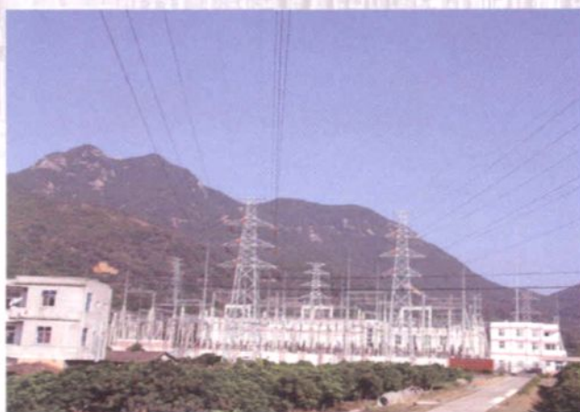
220千伏荔城变电站(主 变压器2台，容量24万千伏 安。2004年12月第一台主变 压器投运，2006年7月第二 台主变压器投运)。该站是 莆田市第三座220千伏变电 站
