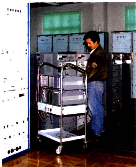
电力载波机房
