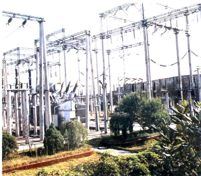
110 千伏金华北郊变电所
