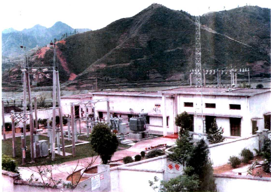
35 千伏淳安临歧变电所
