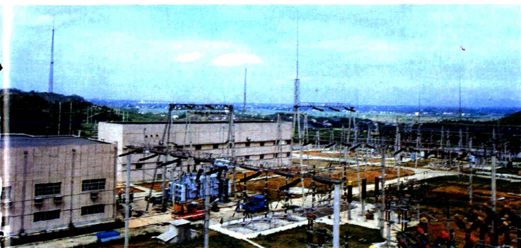
220 千伏云山变电所
