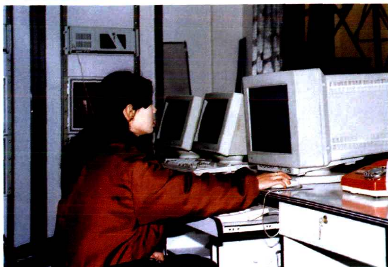
金华电业局电力调度所远动机房
