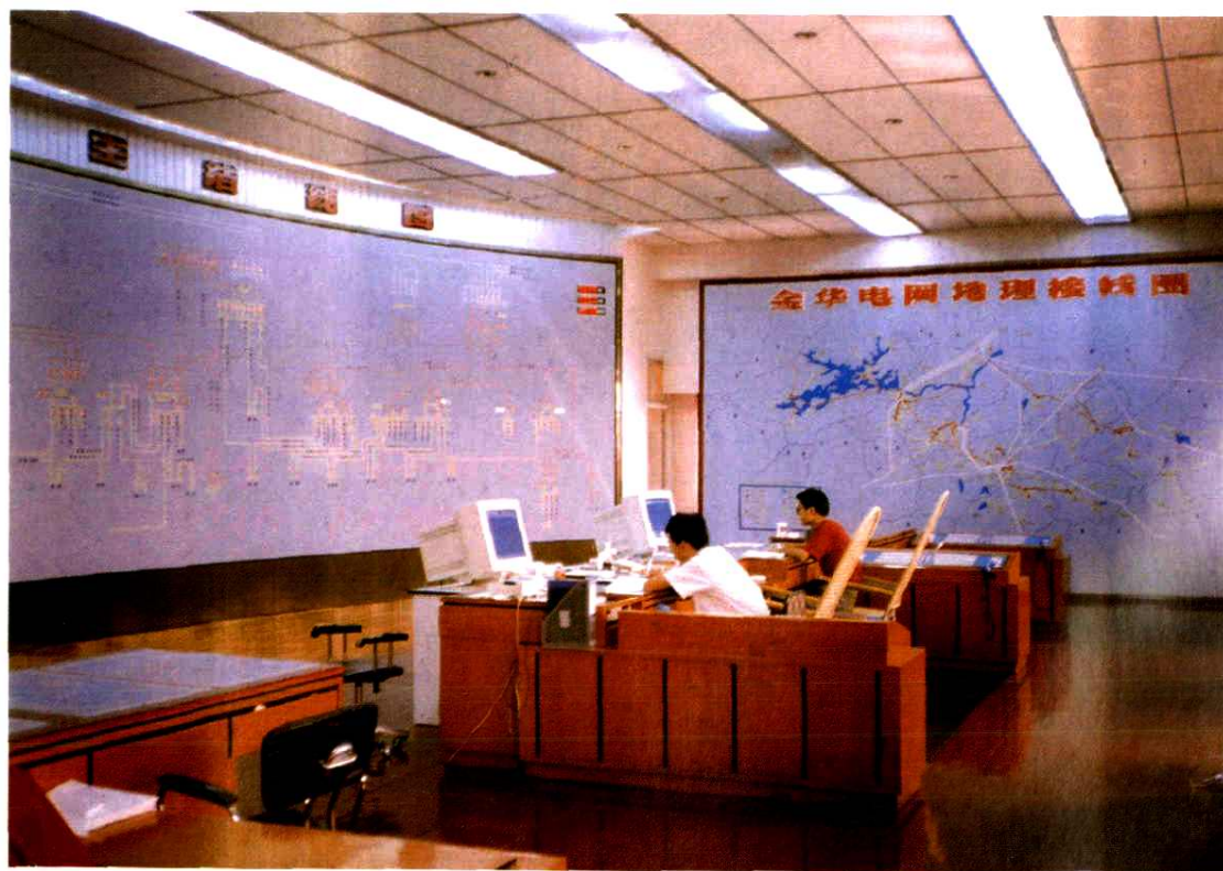
金华电业局电力调度所
