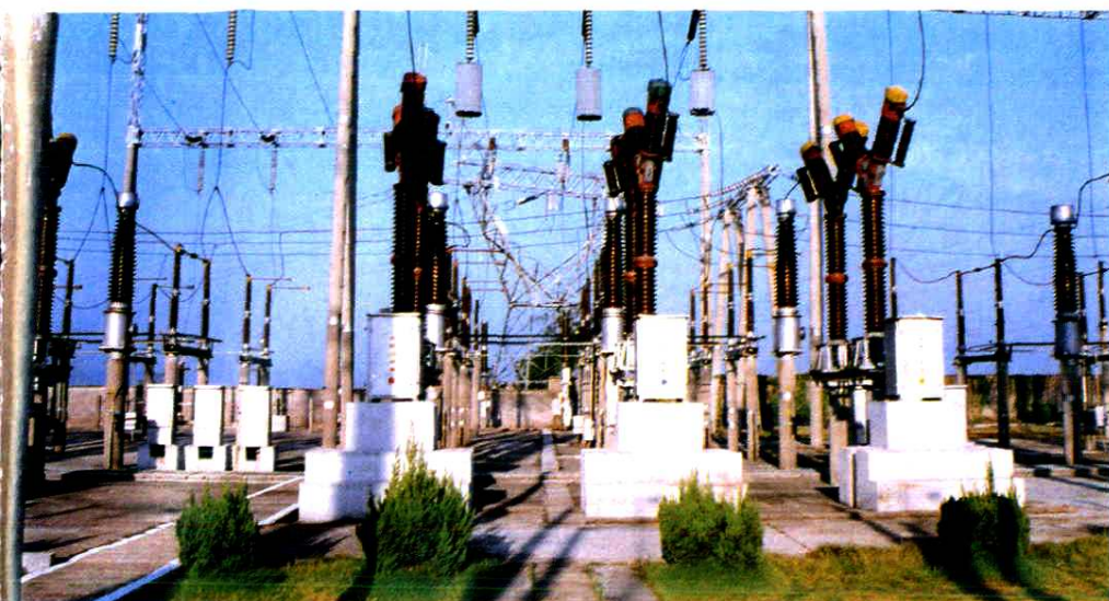
220 千伏金华变电所
