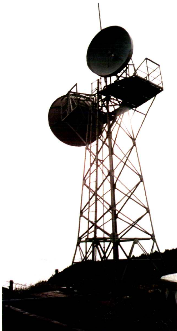
金华北山顶上的电力微波中继站
