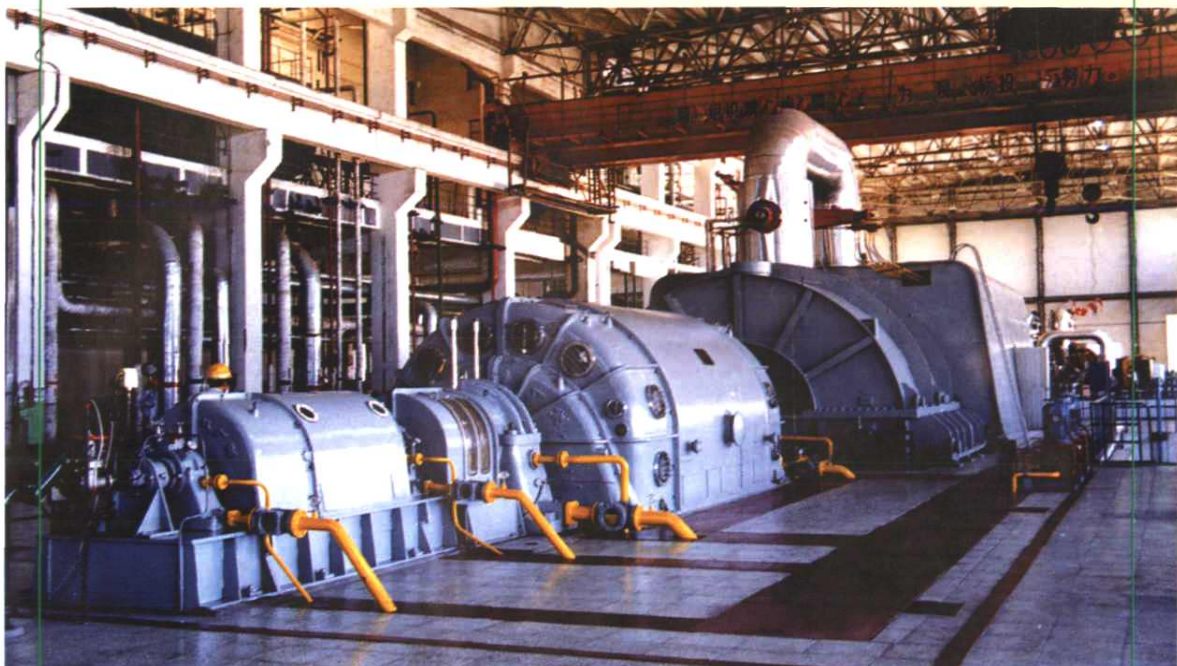
苇湖梁电厂新机组
