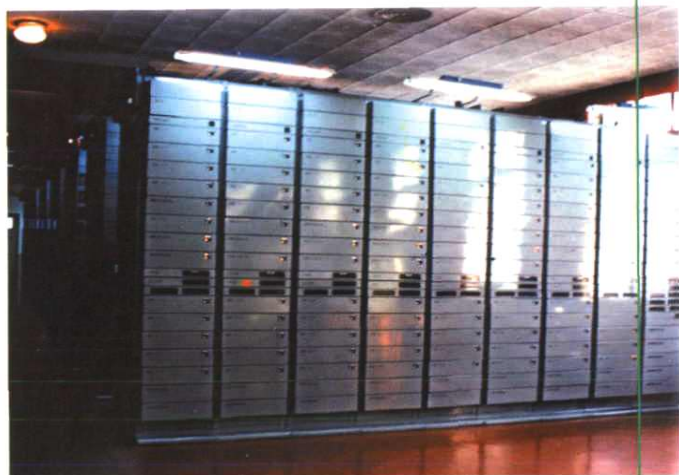
市电信四分公司纵横制机房
