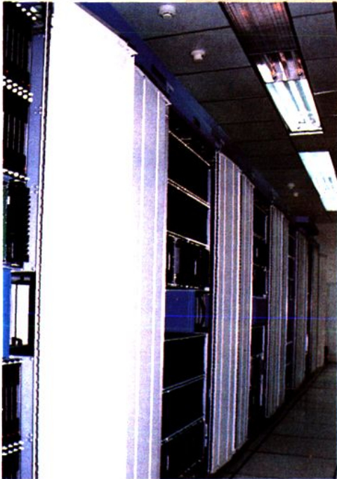
程控电话机房
