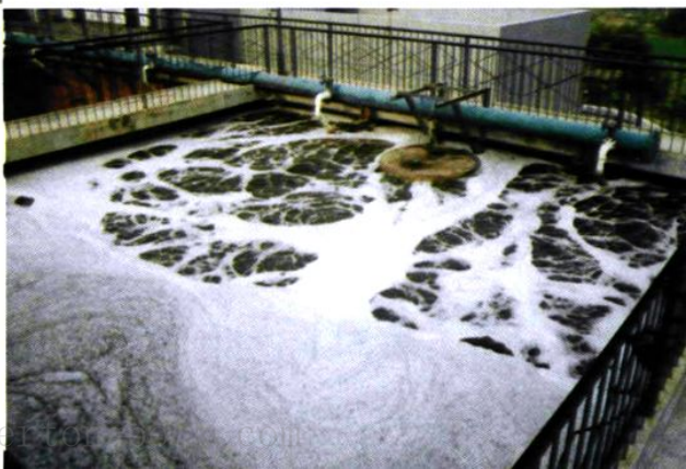
新污水处理站一角
