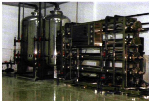
新建纯水处理系统
