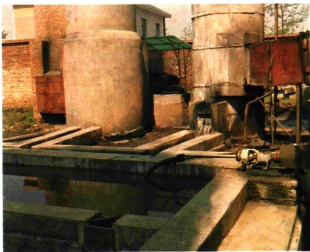
过去的水处理设施
