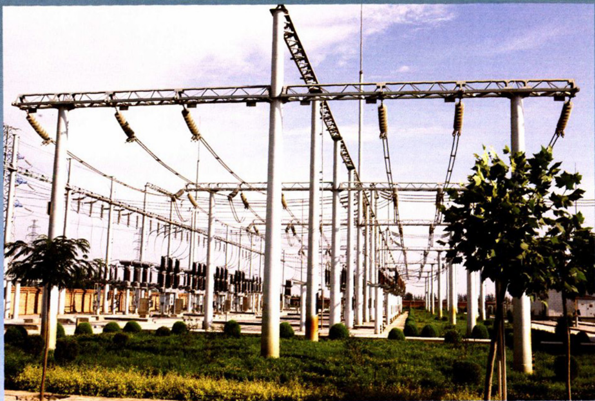
利通 220 千伏变电站
