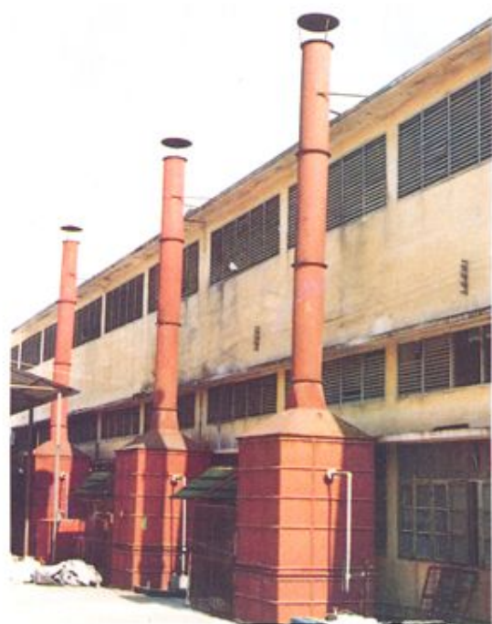
兴通铝材厂氧化车间废气处理装置。
