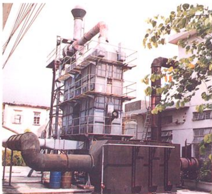
南海县墙纸厂增塑剂高效静电回收装置。
