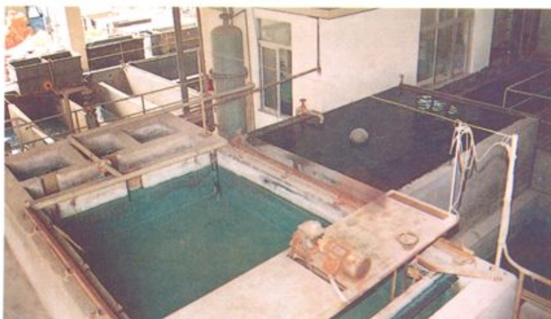
平洲电镀厂的电镀废水处理设施。
