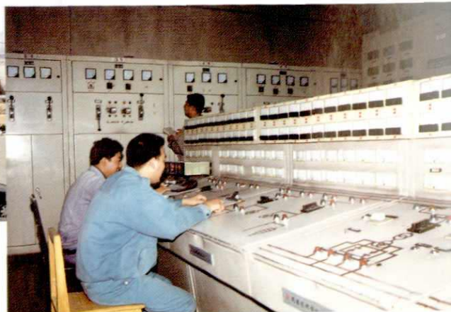
纳税大户——龙门电解铝厂。图为 厂供电主控室
