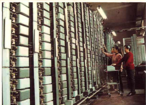
步进制交换机房(1985年摄)
