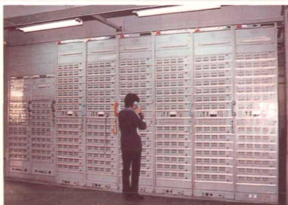
载波电话机房(1983年摄)
