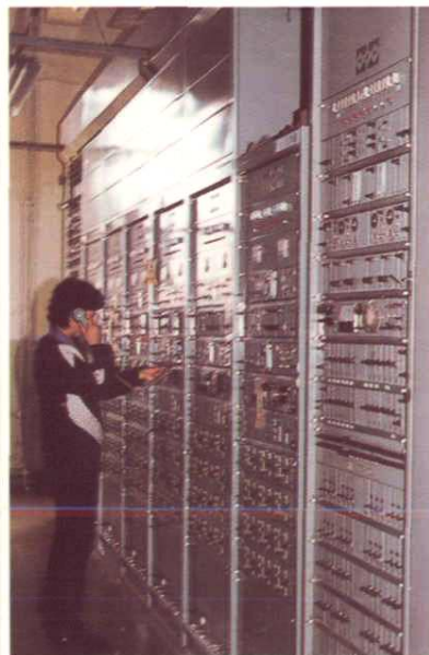
市内电话机房(1983年摄)
