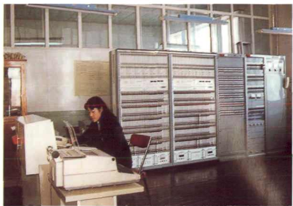
140 线用户电报交换机房(1985 年摄)
