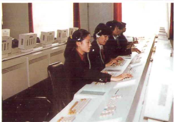
长途半自动交换机房(1985 年摄)
