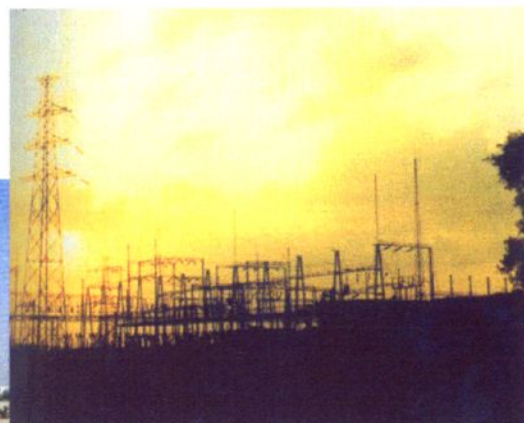
220KV昆山变电站
