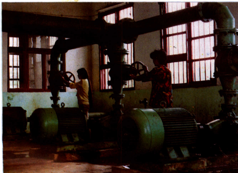
杨弯桥水库提水站一级泵房
