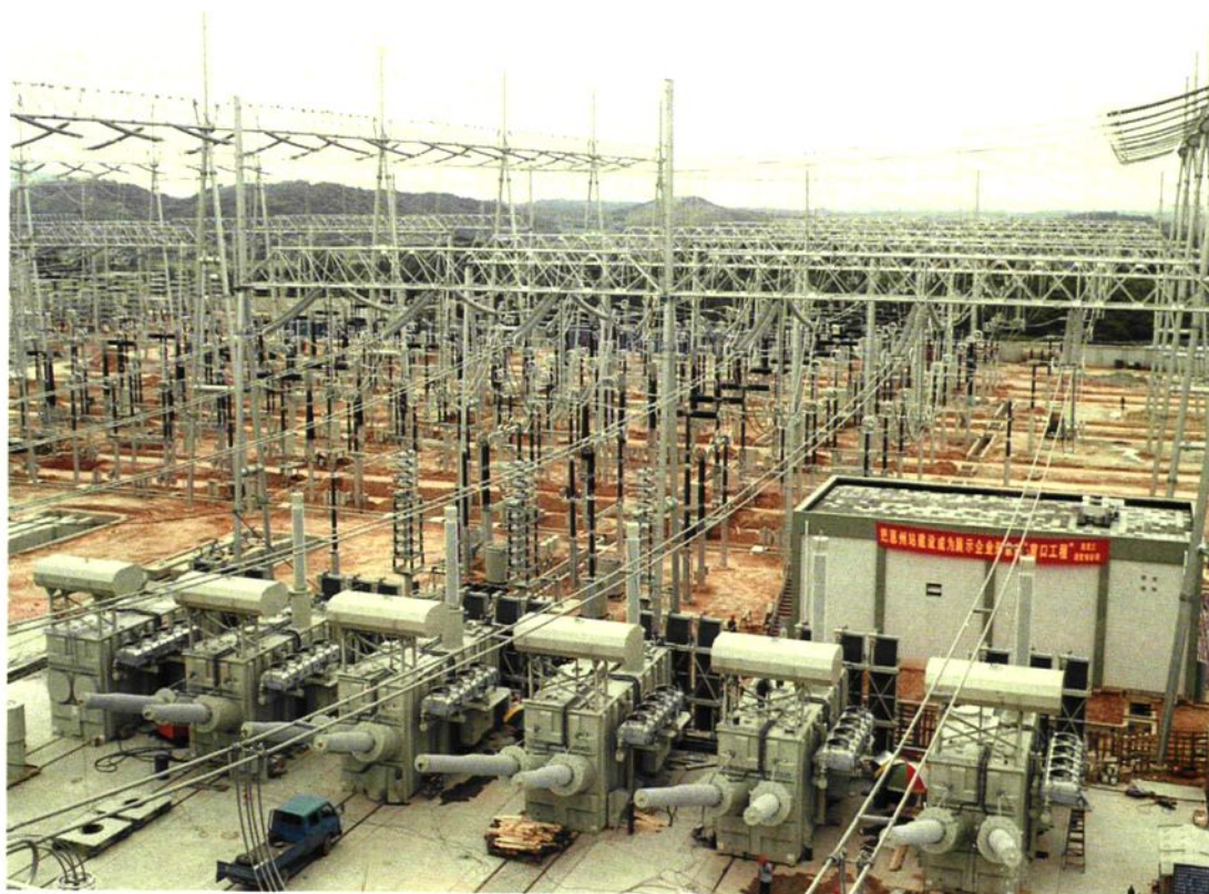
500kV 三峡送出工程广东惠州换流站(2002)
