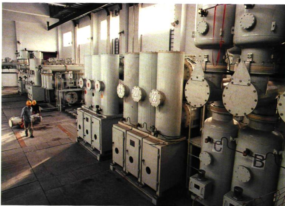
220kV 郑州人民变电站(全室内), GIS组合电气设备(2001)
