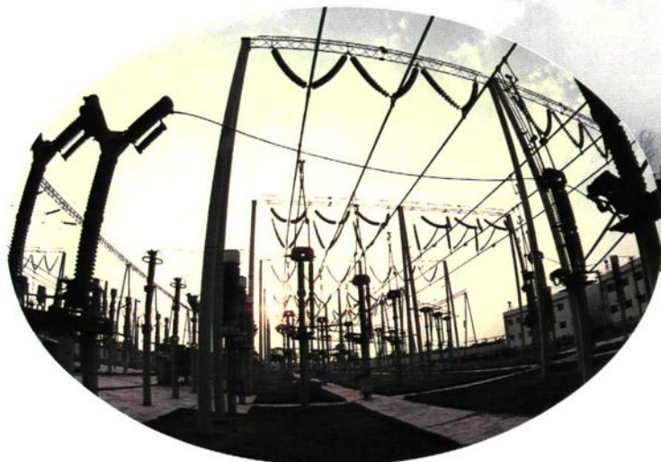
承建220kV安阳杜家庵变电站(1991,部优)
