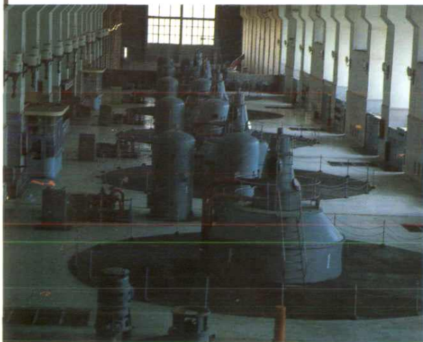
电站厂房安装了5台5万千瓦国产水轮发电机组 (秦军校摄)
