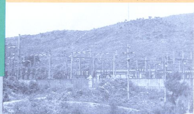
金家塘35千伏变电所
