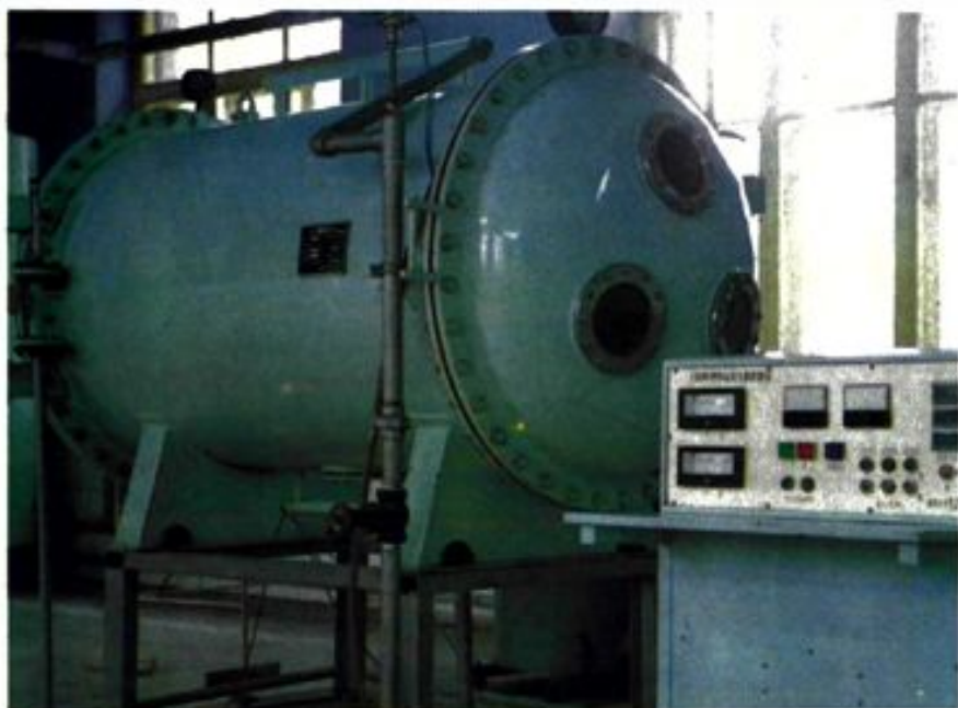
牡丹江铁路医院医疗废水处理车间臭氧发生器
