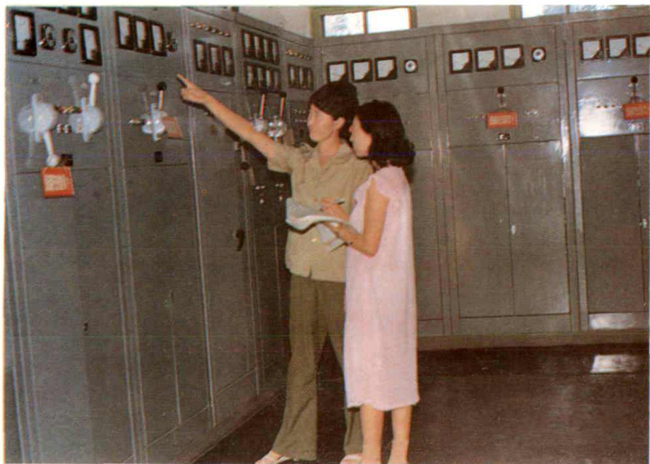
第二水厂机房之一角
