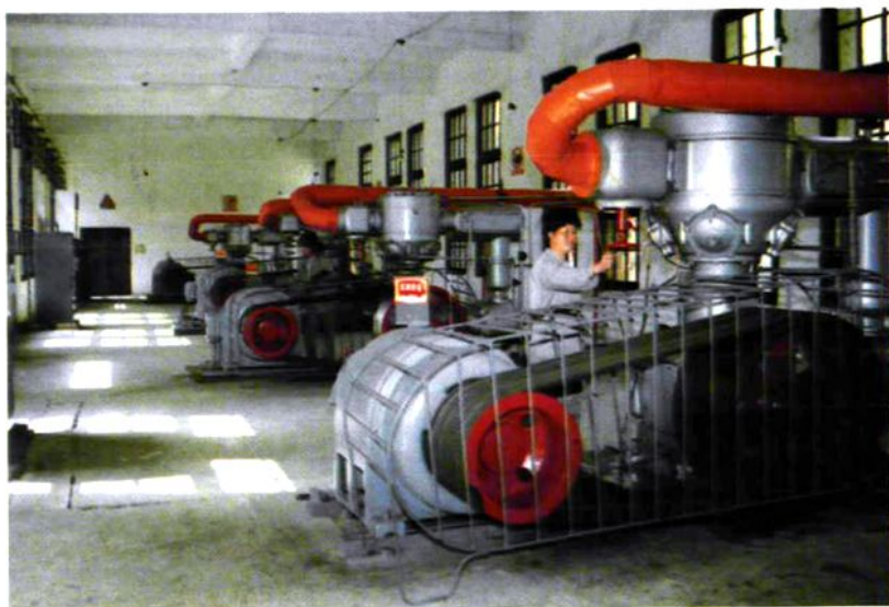
空壓機班精心維護設備
