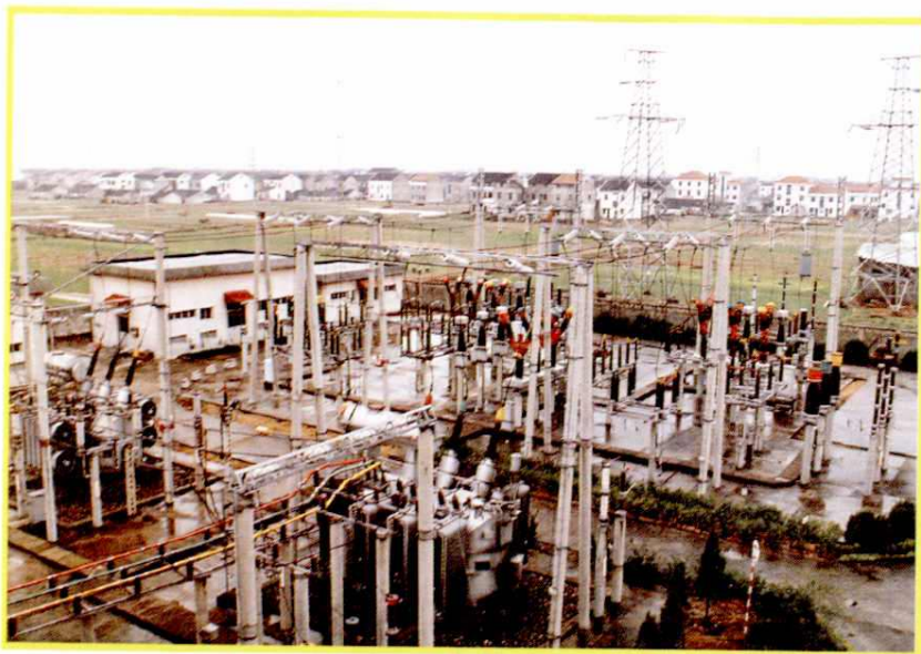
1993年建成的110千伏长河变电所
