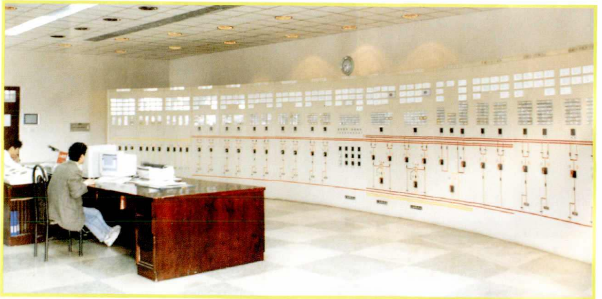
220 千伏慈溪变电所主控制室
