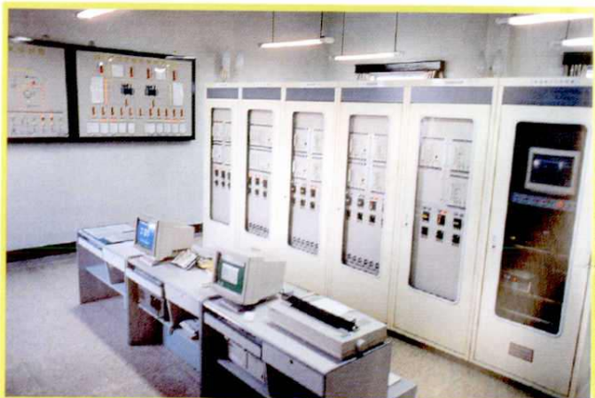
35千伏综合自动化匡堰变电所控制室
