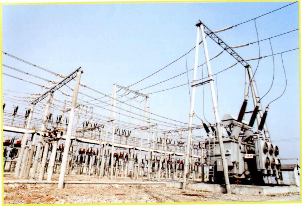
1995 年投运的 220 千伏慈溪变电所
