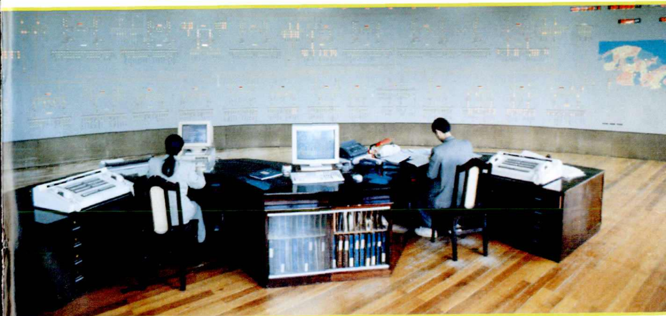
慈溪市供电局电力调度室
