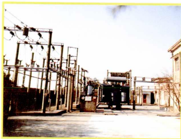
1982年建成的35千伏师桥变电所
