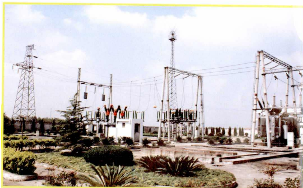
1995年7月投运的 110千伏新浦变电所
