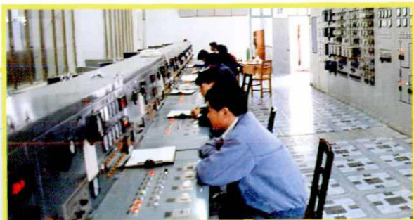
慈溪调峰电厂主控制室
