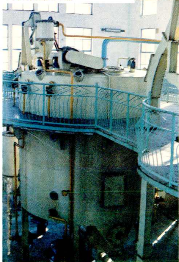
23. 新沂县油脂化工厂浸出车间油脂浸出器
