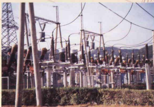
110KV河田变电站
