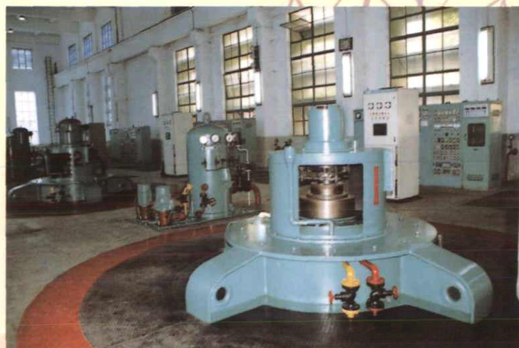
1982年建成的南告水电厂，装机容量 3 \times 1.5 万千瓦，图为水电厂厂房。
