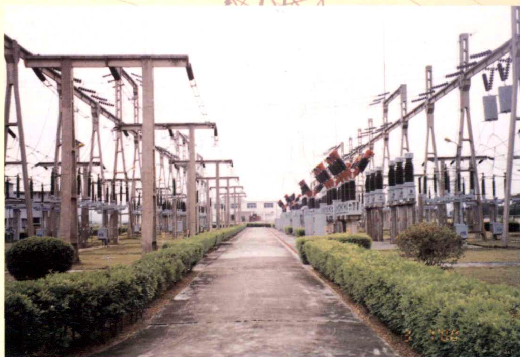
1993年建成投产的第一座220KV变电站——桂竹站，担负着汕尾全市电力供应。
