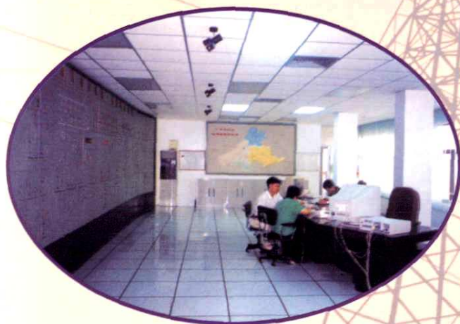
▲ 汕尾电力局电网调度自动化通过省电力局验收，图为电力调度自动化控制中心。
