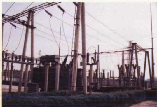
110KV河西变电站
