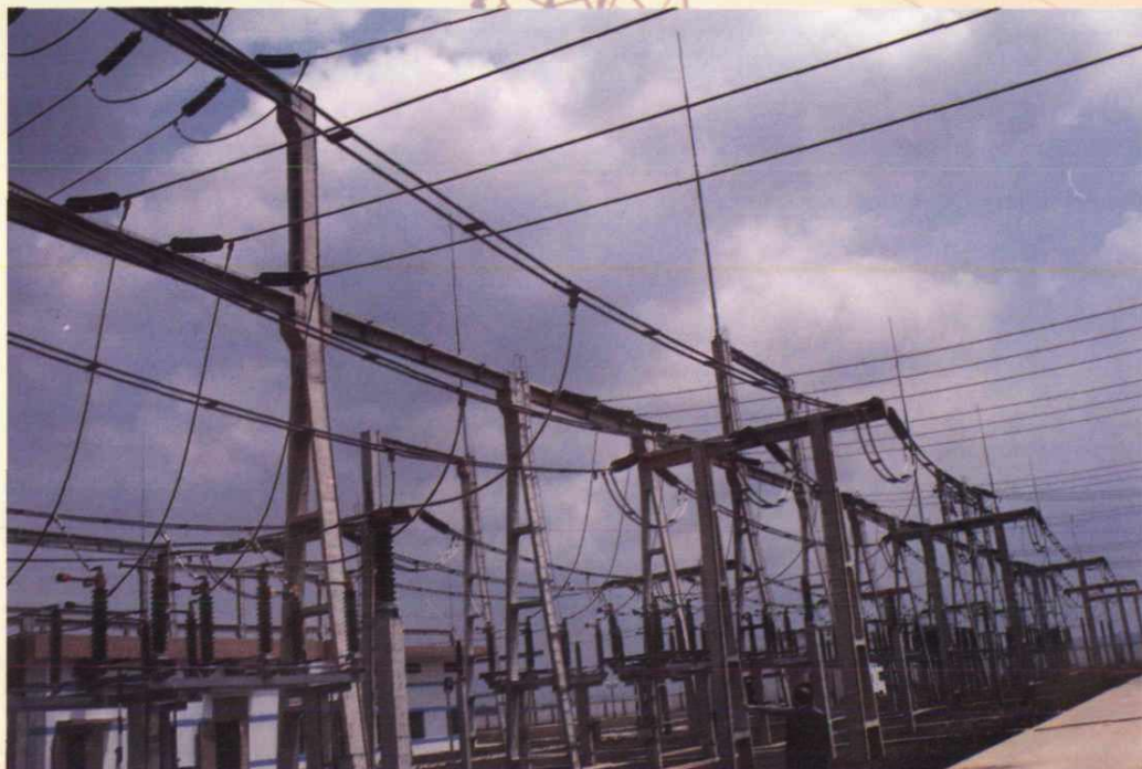
220KV星云变电站
