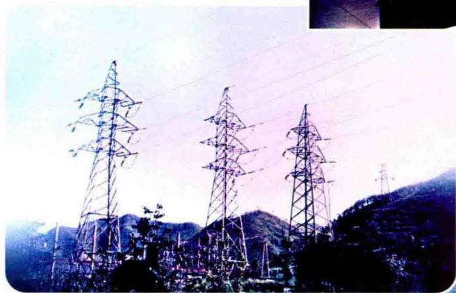
110 千伏输电线路
