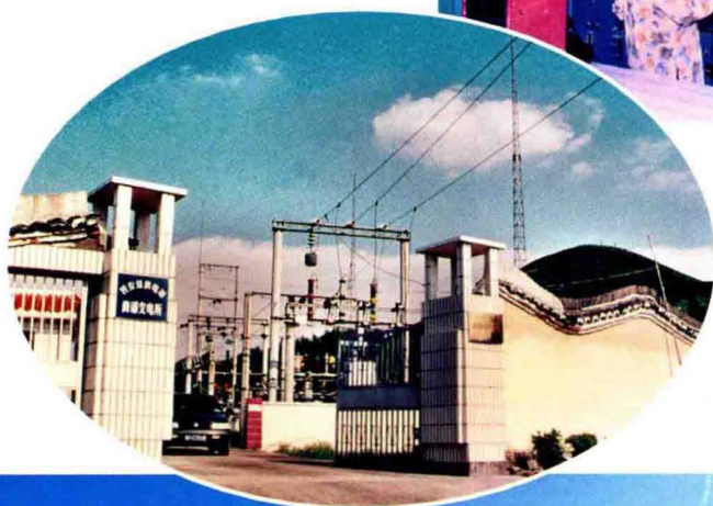
35 千伏尚湖变电所
