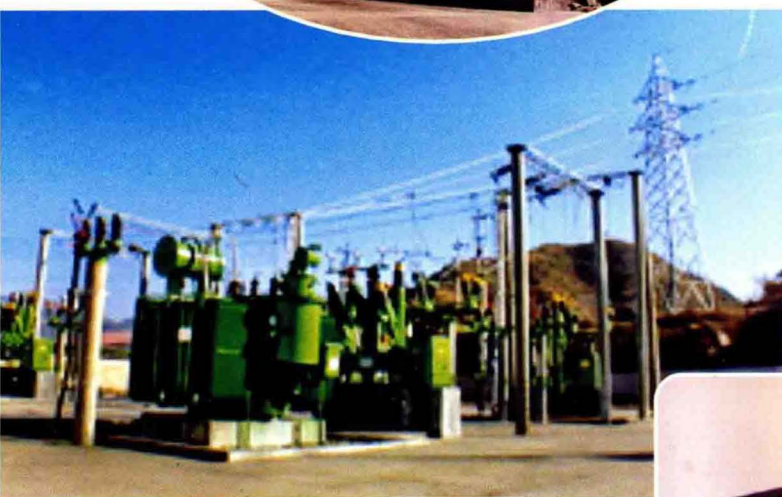
35 千伏仁川变电所
