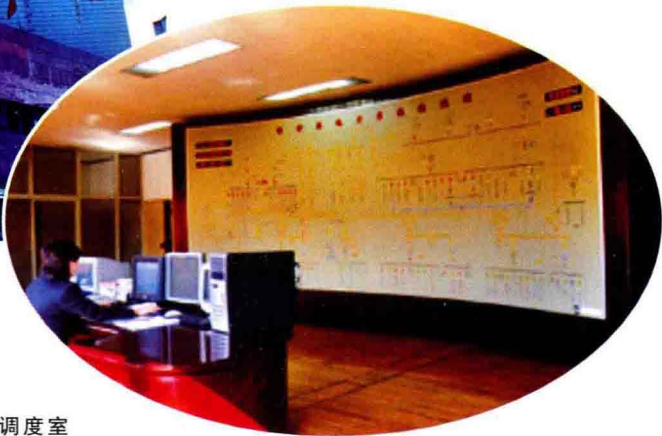
磐安县电力调度室
