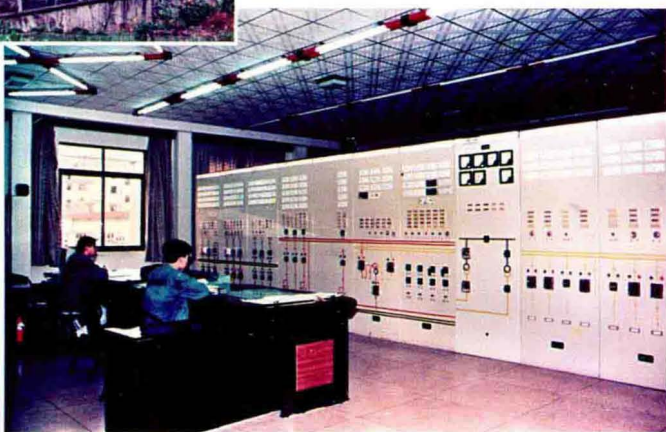
110 千伏磐安变电所主控室
