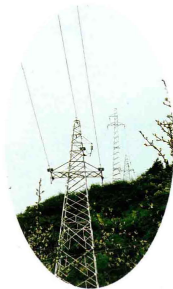
35 千伏输电线路
