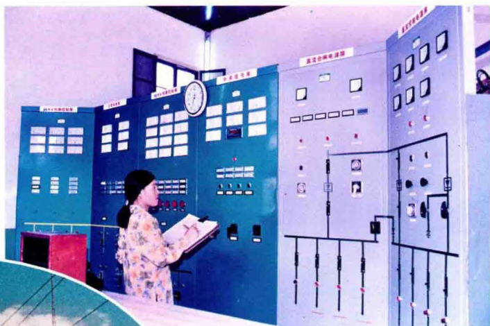
35 千伏岭口变电所主控室
