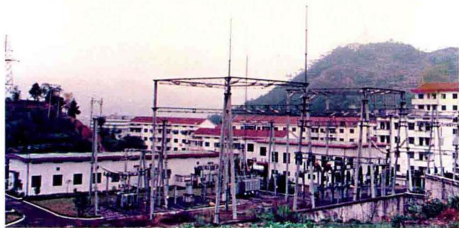
110 千伏磐安变电所
