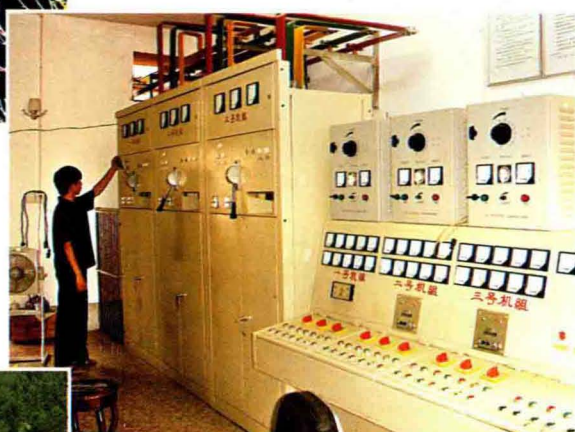
龙潭溪二级水电站集控室
