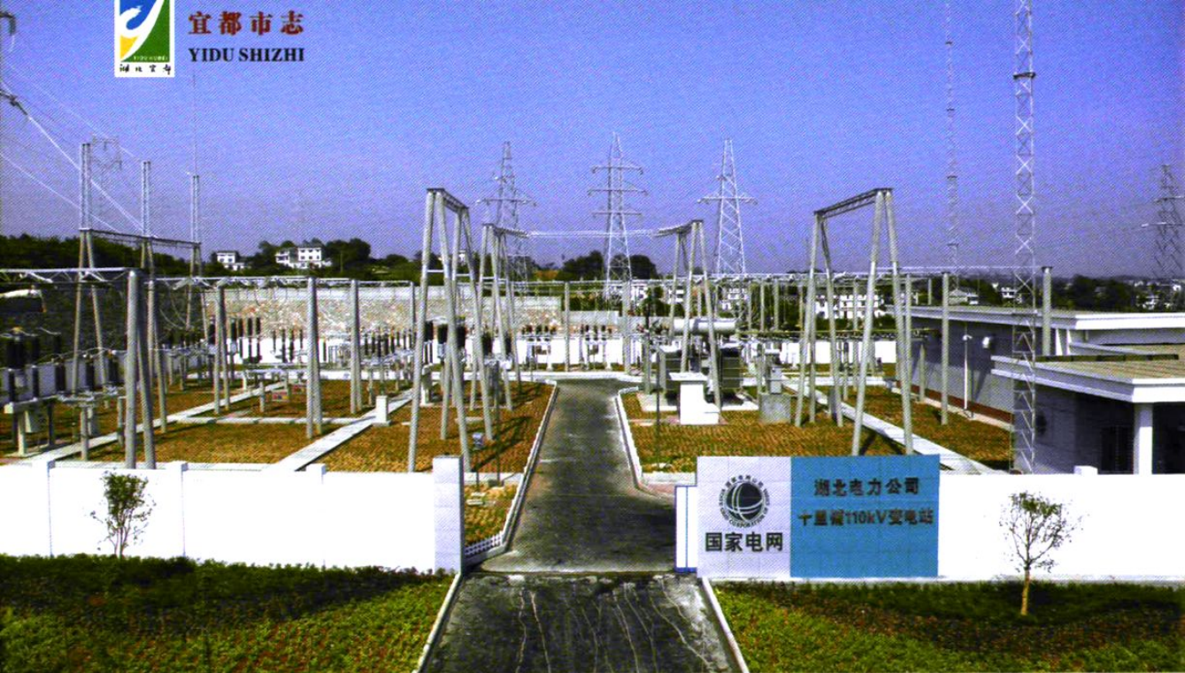
陆城十里铺110KV变电站（2008年摄）
