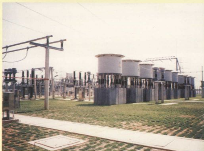
广东省粤西地区第一座500千伏变电站一角
