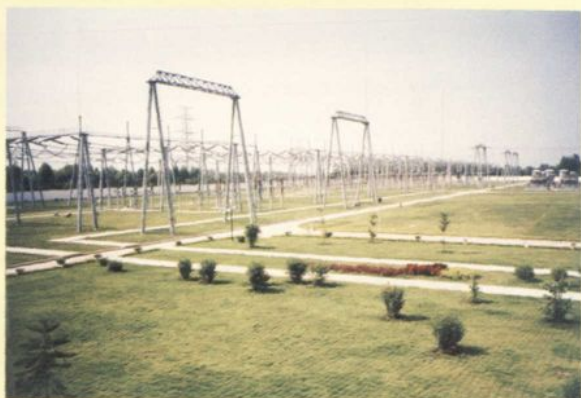
500千伏茂名变电站220千伏接线场
