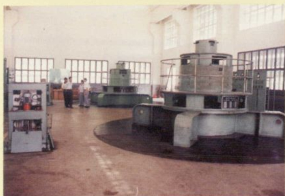
高州市良德水电站机组
