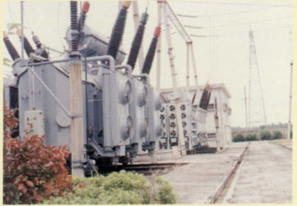
220KV河东变电站主变
