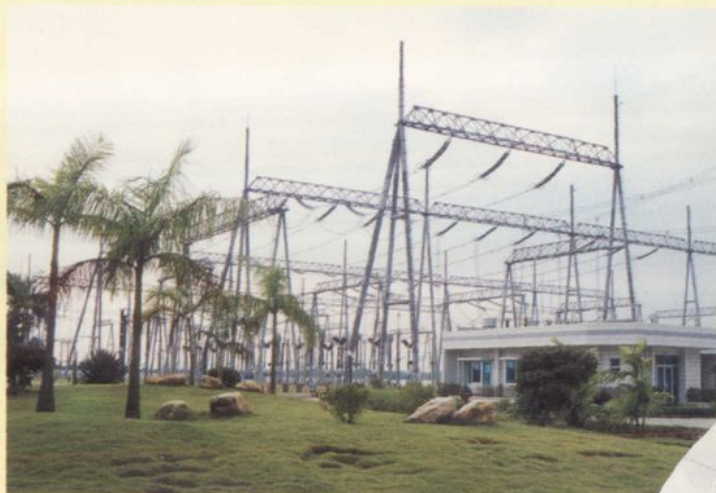
500千伏茂名变电站荣获茂名市绿化先进单位
