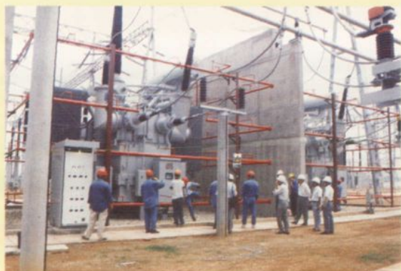
工程技术人员对500千伏茂名变电站主变进行检查测试
