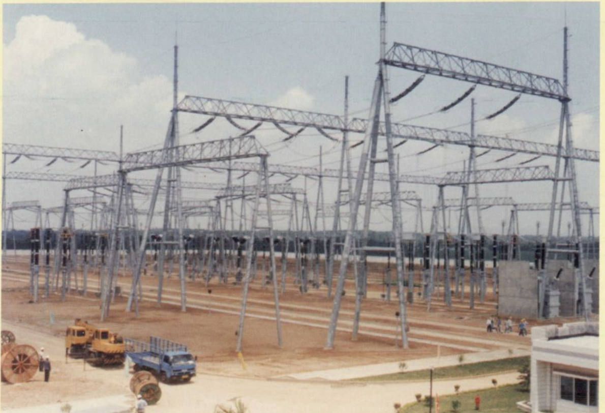
500千伏茂名变电站500千伏结线场
