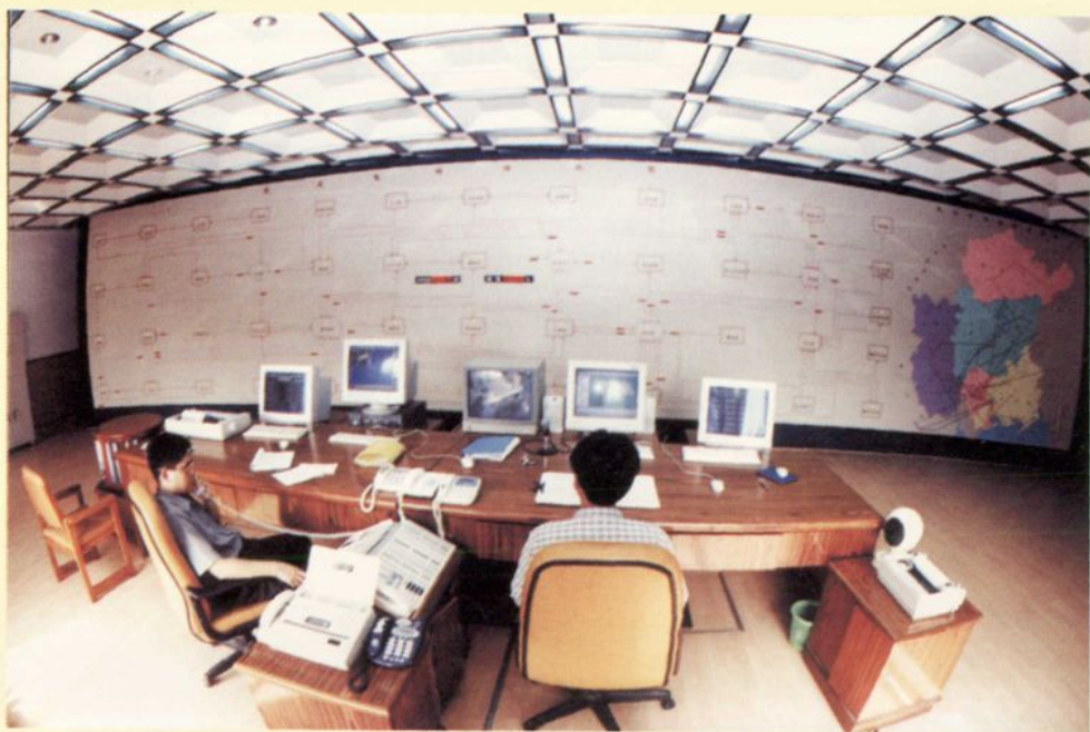
茂名电力调度室
