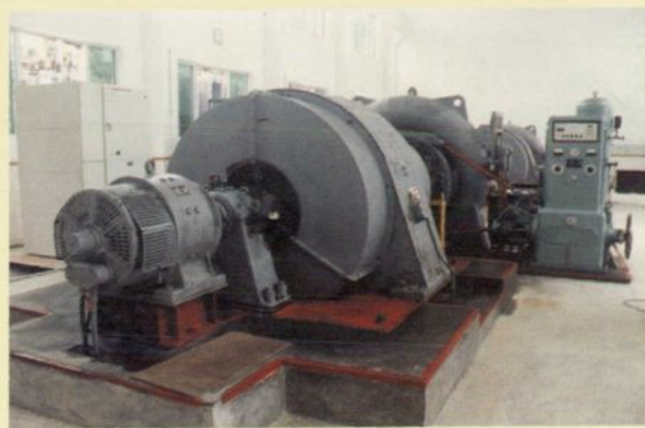
信宜市扶曹水电站机组
