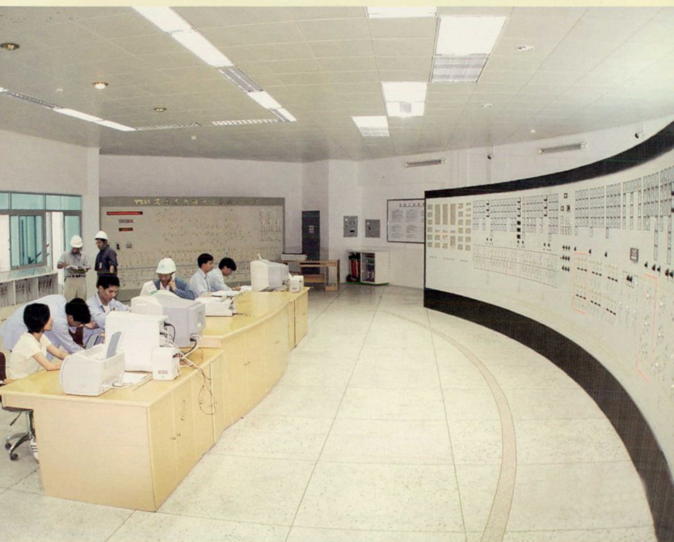
500千伏茂名变电站主控室
