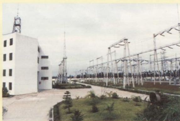
220KV榭平岭变电站一角
