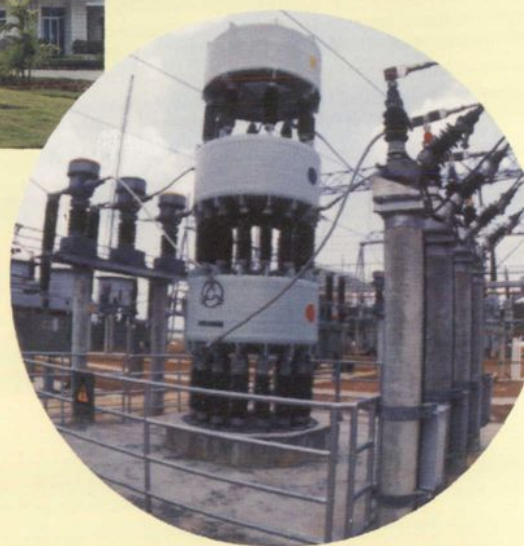
500千伏茂名变电站电抗器
