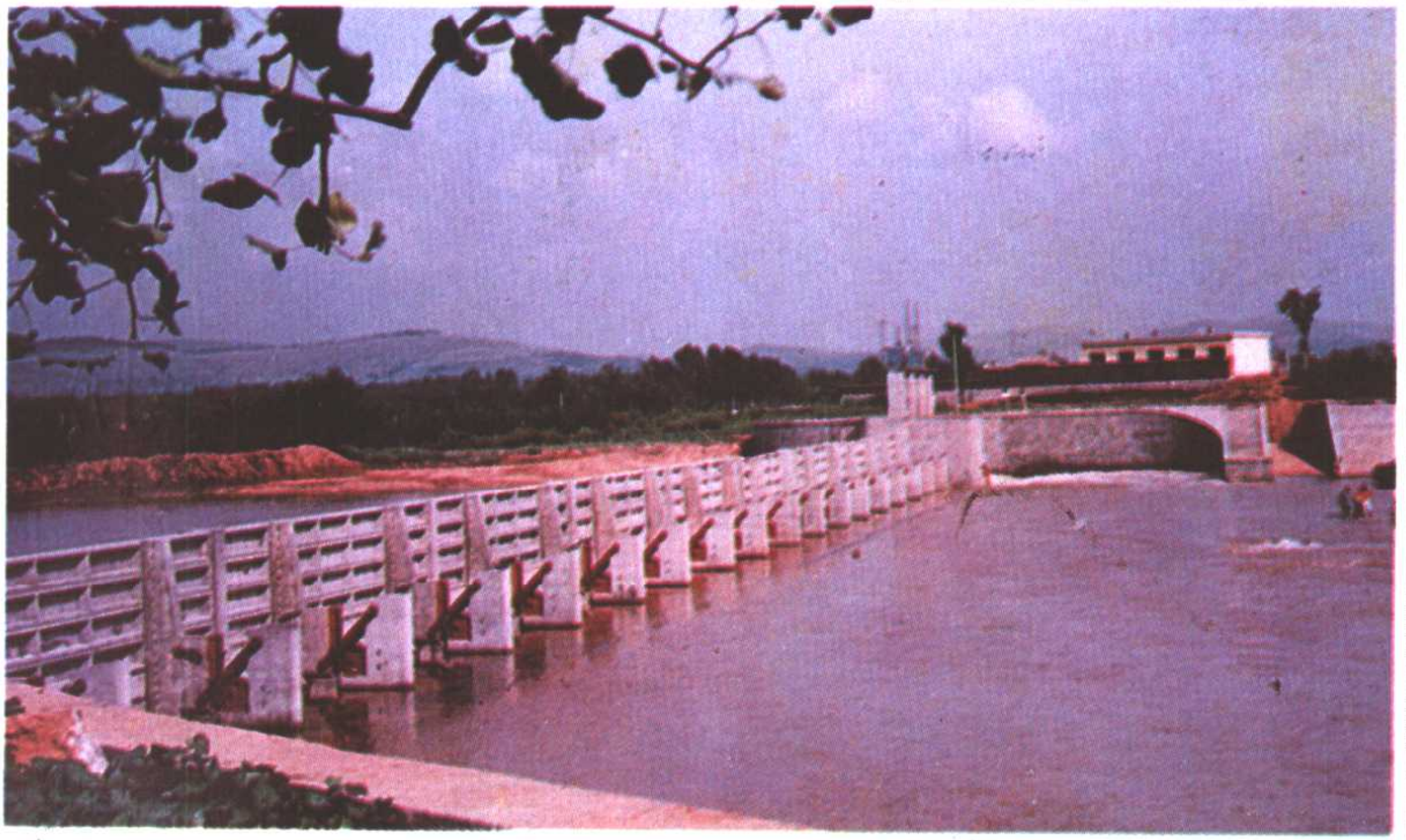
十字河自控翻板闸
