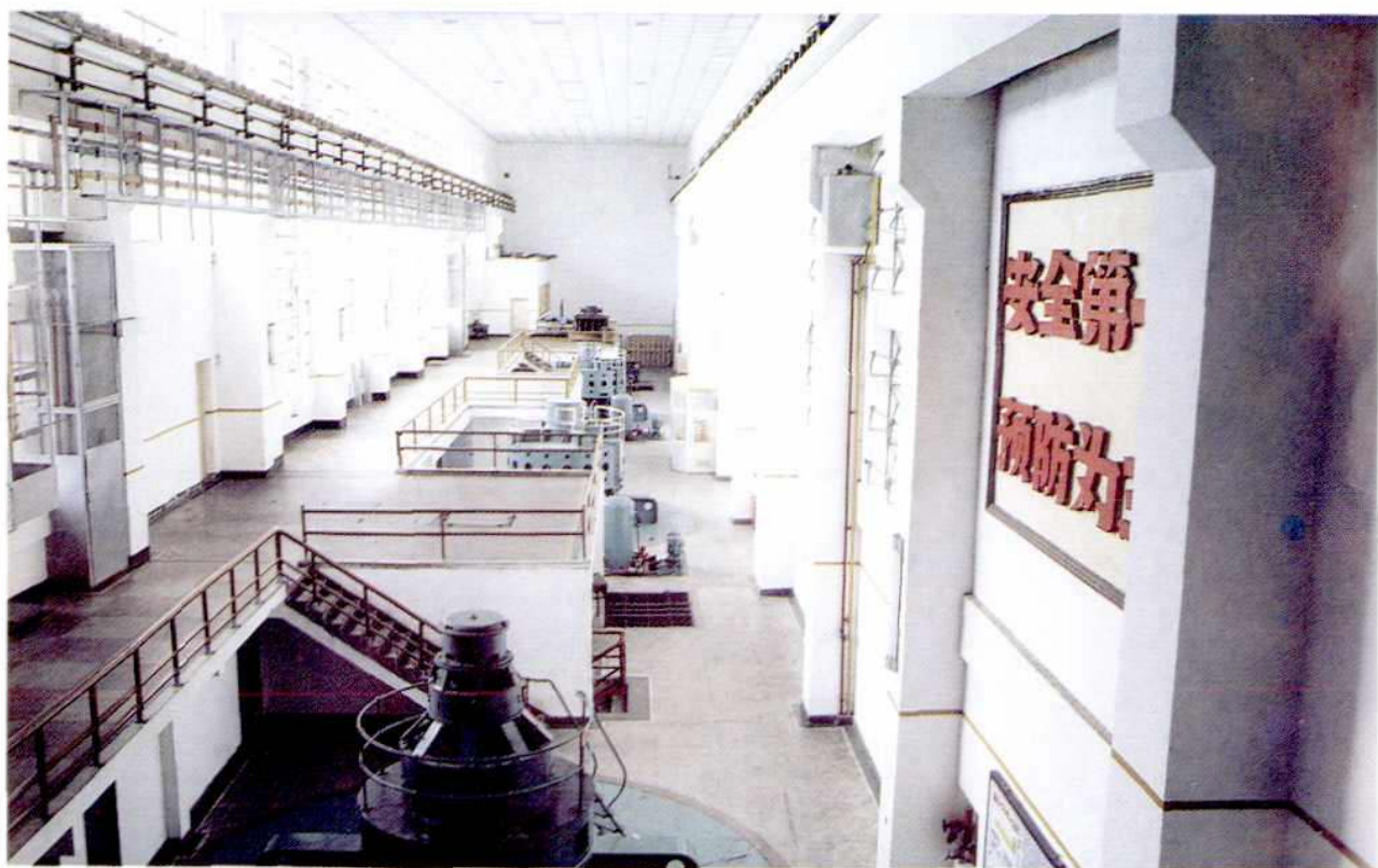
发电厂房内景
