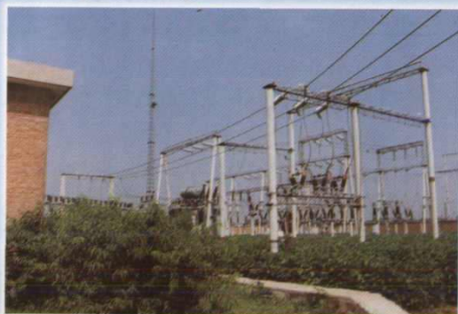
高阳 110 千伏输变电站
