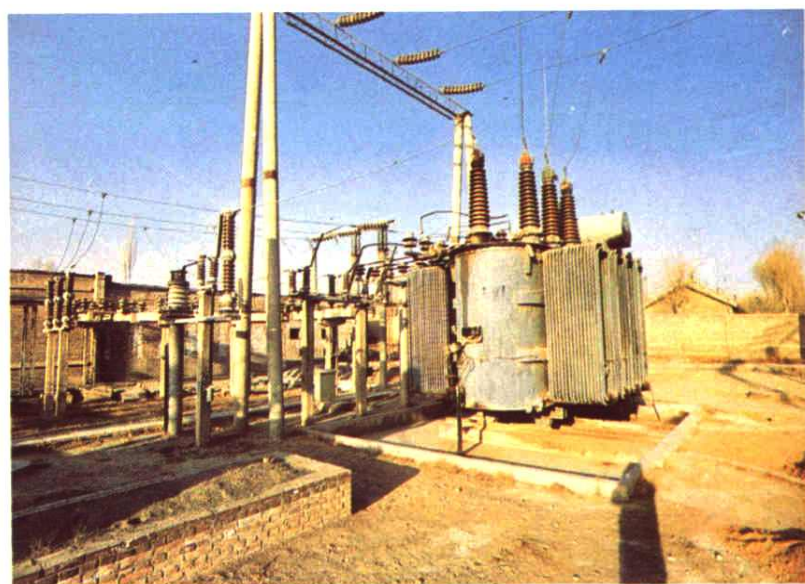
永登中堡220千伏变电站
