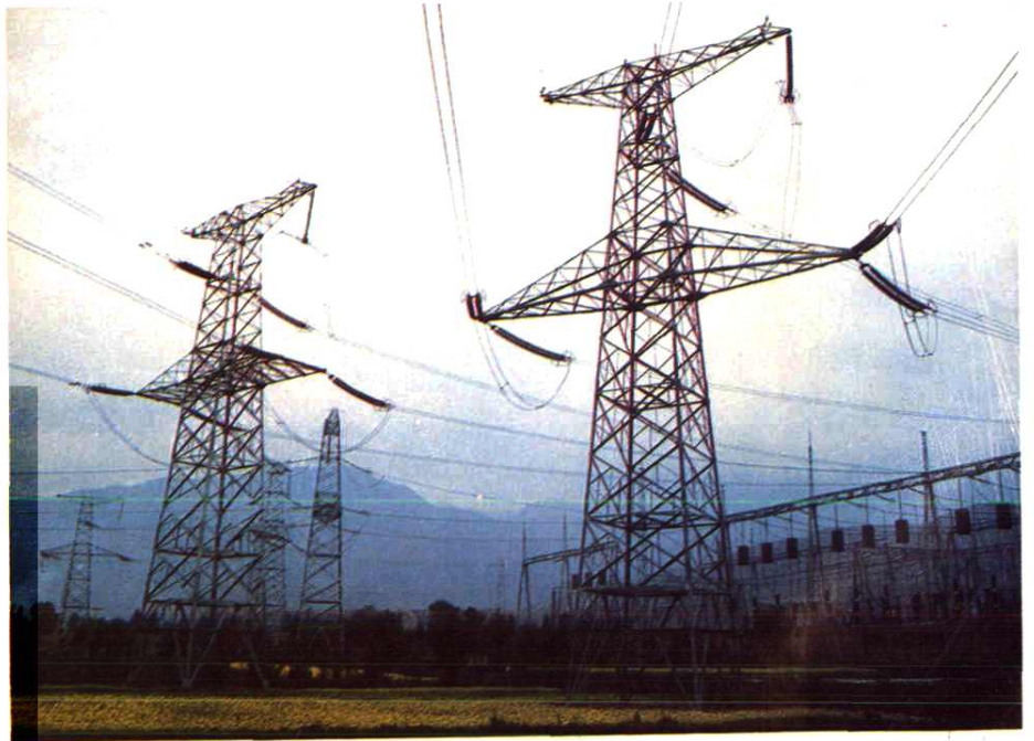
220 千伏 输电 线路
