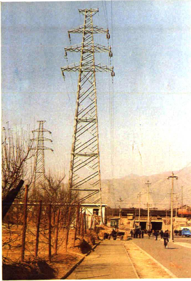
110 千伏 输电 线路
