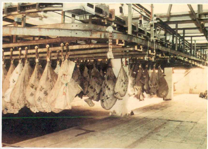
广州邮政枢纽的邮件 推式悬挂输送贮存系 统
