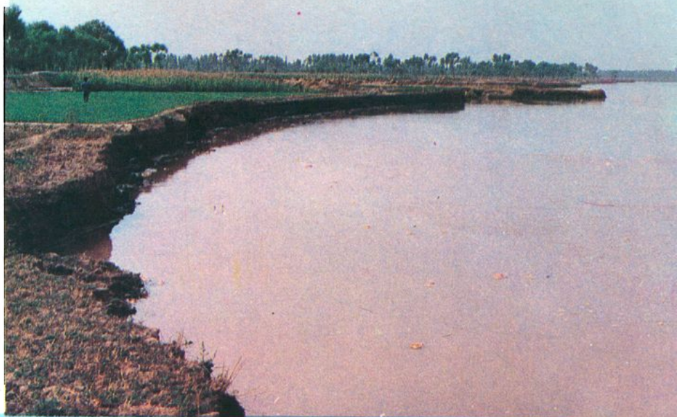
高仁镇黄河塌岸
