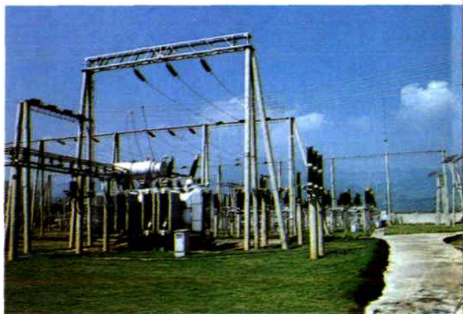
110千伏输变电站
