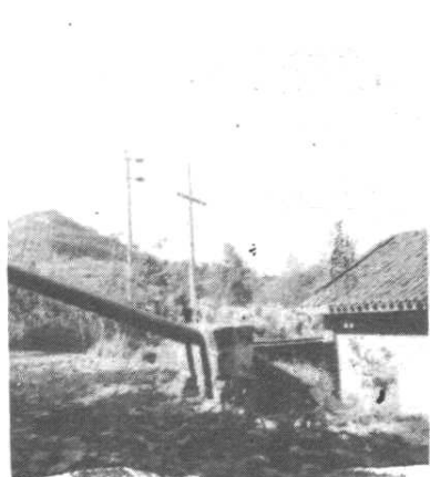
李家咀二级电灌站（自压进水）
