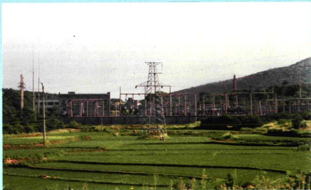
城关110千伏变电站
