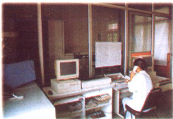
内部程控电话机房
