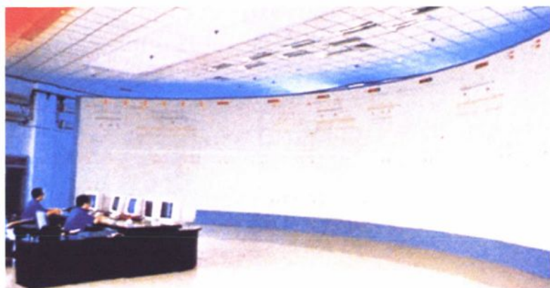
廊坊地区电力调度大厅
