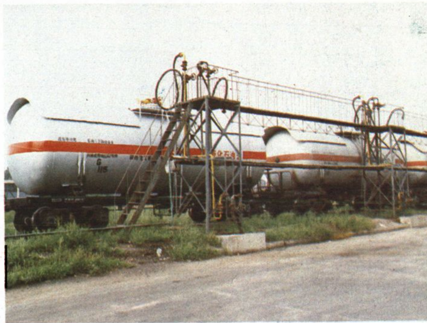
► 液化气火车槽车卸车线
