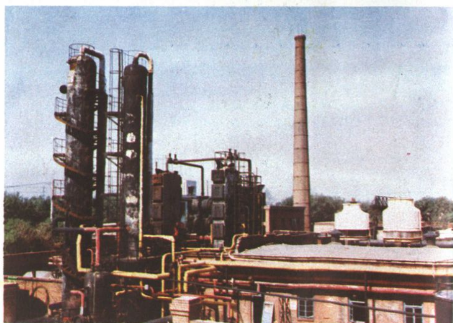
► 炼焦煤气厂 粗苯回收设备
