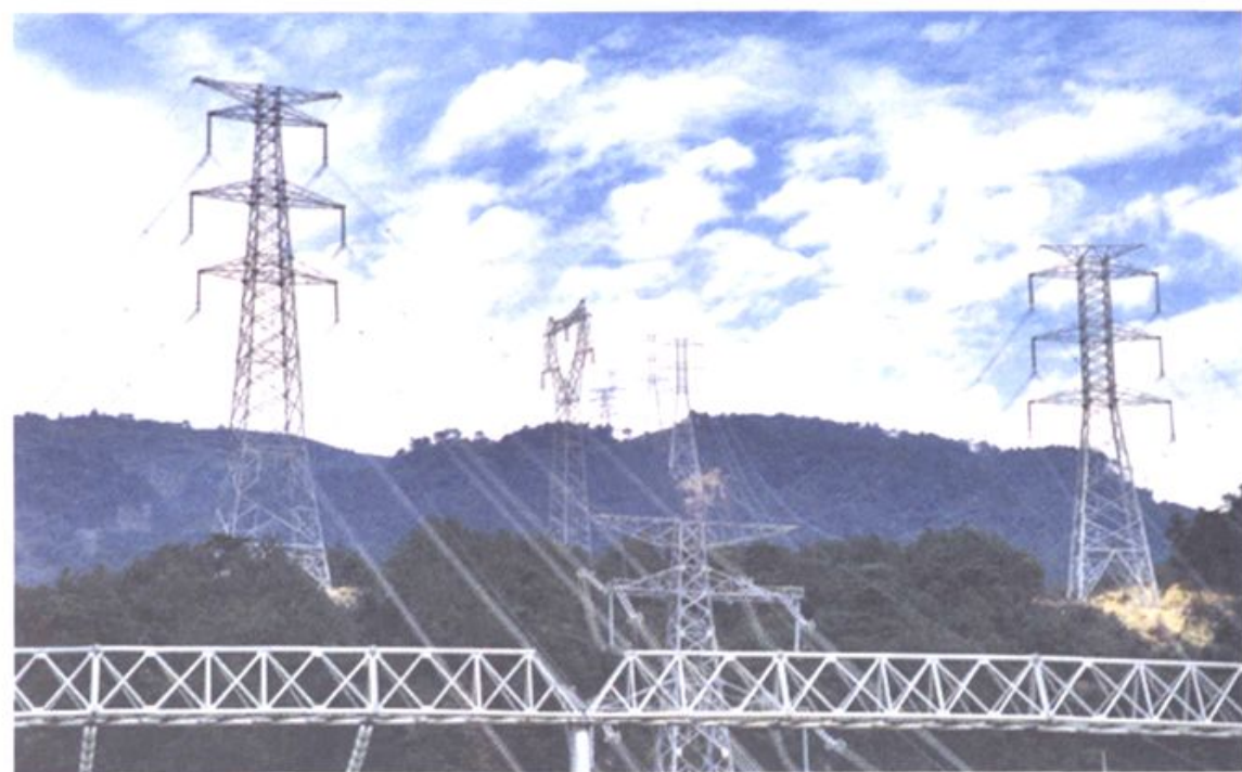
2002 年竣工的福州 500 千伏变电站出线
