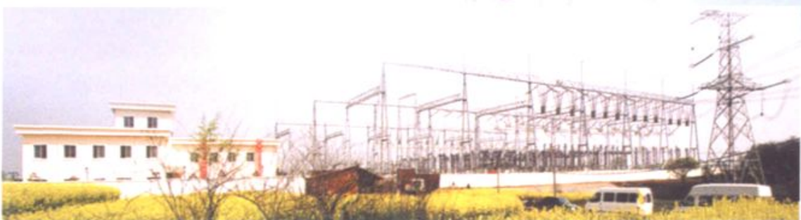
2002年4月竣工的湖北荆门500千伏变电站
