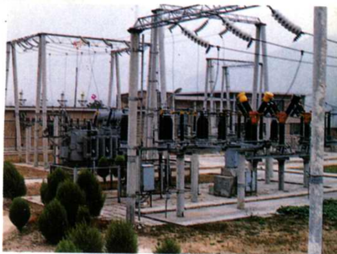
▶ 黎城县 110 KV 变电站
