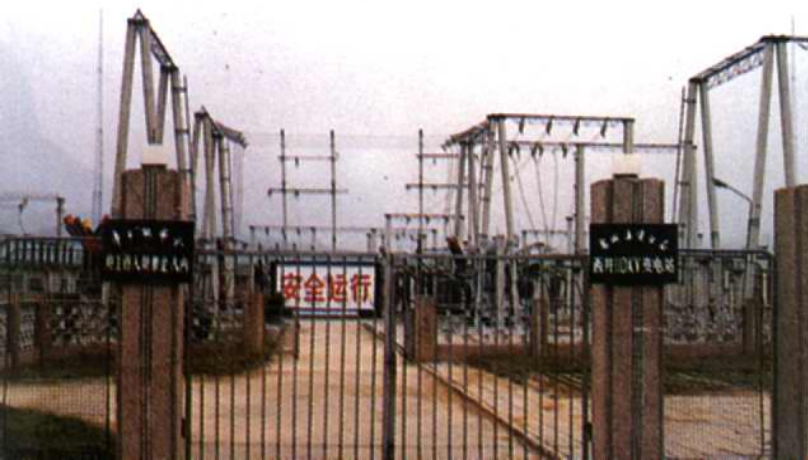
◀ 西井 110 KV 变电站
