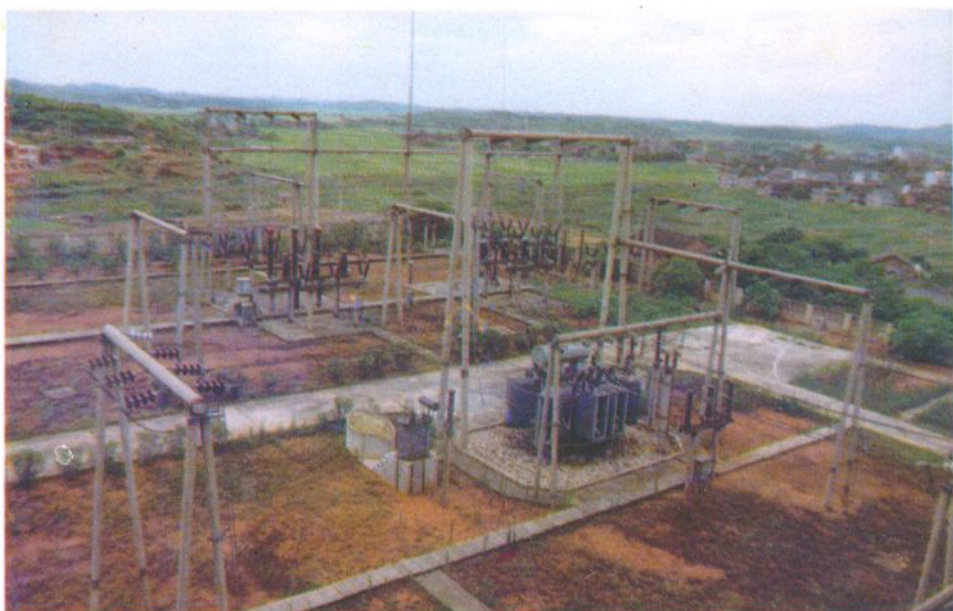
110千伏刘家岭变电站于1983年4月开始兴建，1987年9月竣工并投产运行。占地面积 11753\text{ m}^2 ，建筑面积 1427\text{ m}^2 。县财政负担全部土建投资63.2万元。该站装有110/38.5/10.5千伏主变压器1台，容量为20,000千伏安。图为该站一角。
