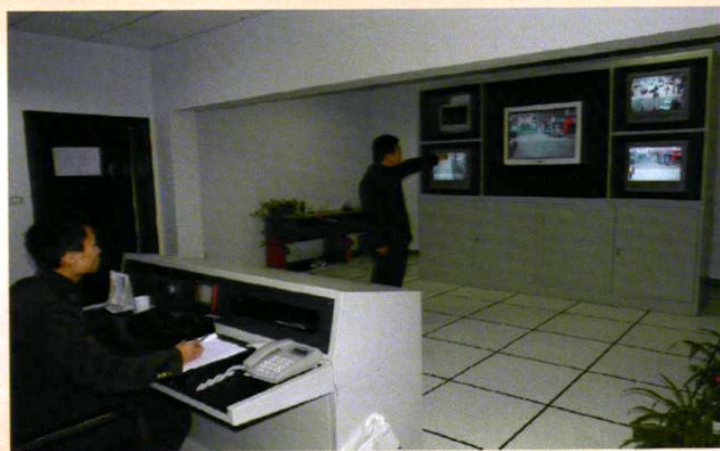
客运站监控室
