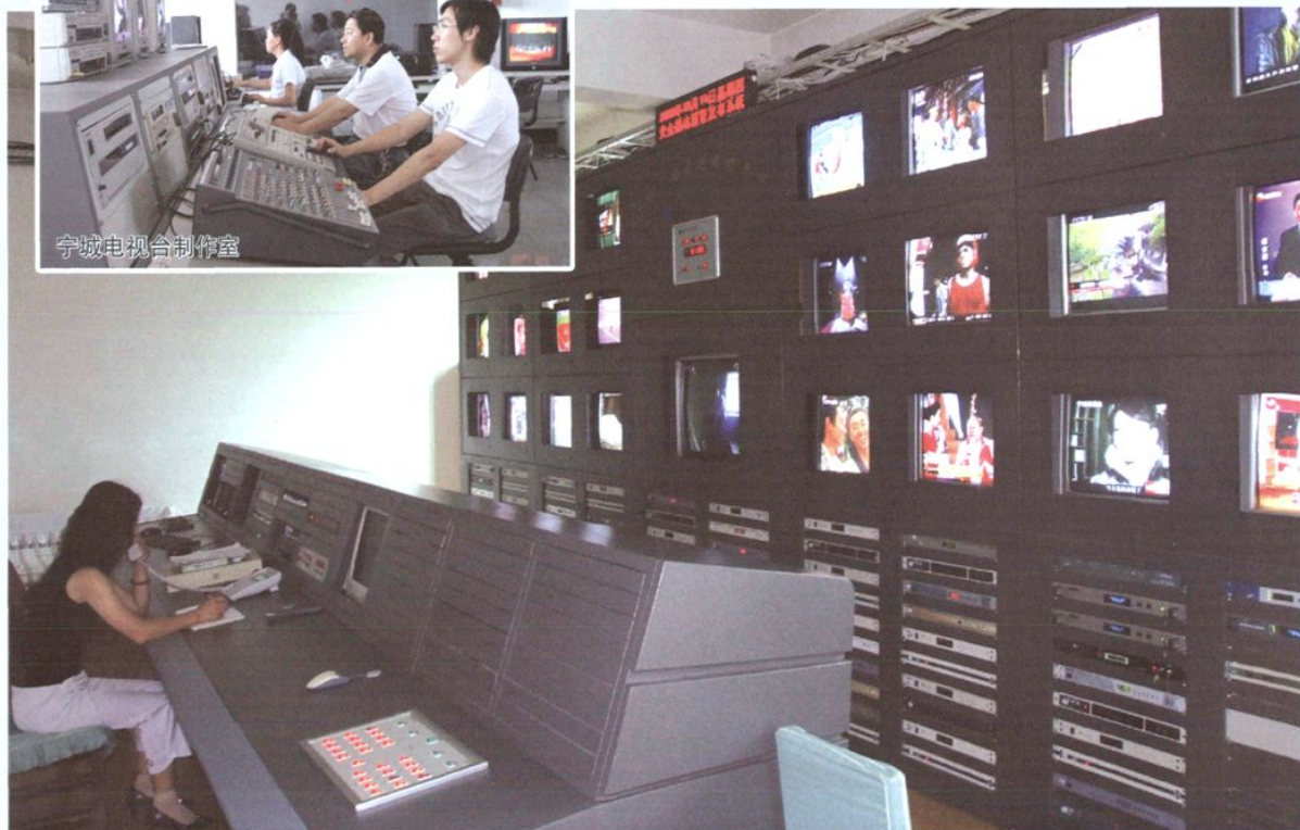
宁城有线电视台播出机房
