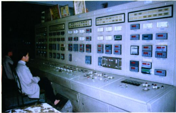
永丰公司3000 K W火电站 中心控制室
