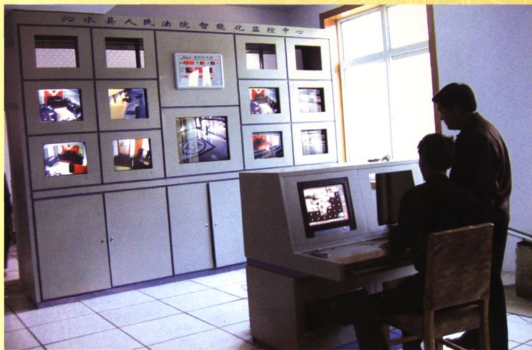
沁水法院电子监控室
