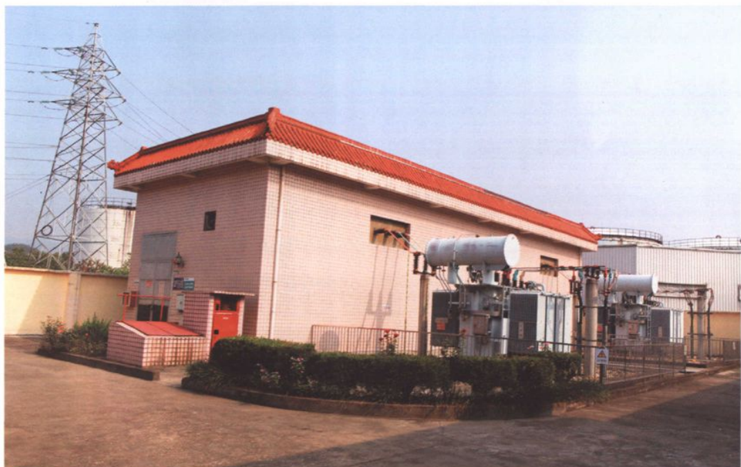
◆ 丽水地区首座35千伏无人值班变电所——水南变电所
