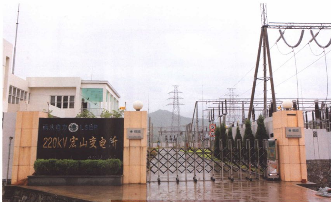
◆ 220千伏龙泉宏山变电所
