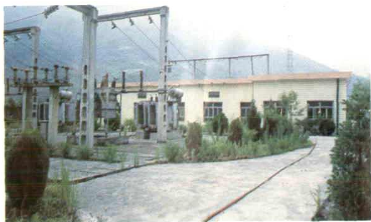
▲平武县电力公司响光35kv变电站。
