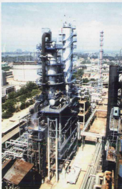
▲30 万吨/年蜡油催化裂化装置
