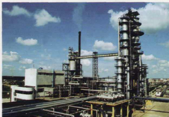
▲50 万吨/年重油催化裂化装置
