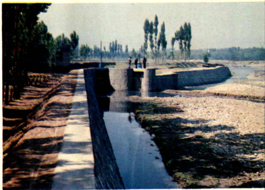
右下 五一前埝翻板闸 下 冯张暗道进口
