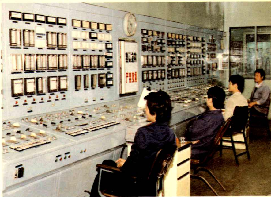
9 号机炉集控室
