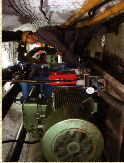
瓦斯抽放井下泵站
