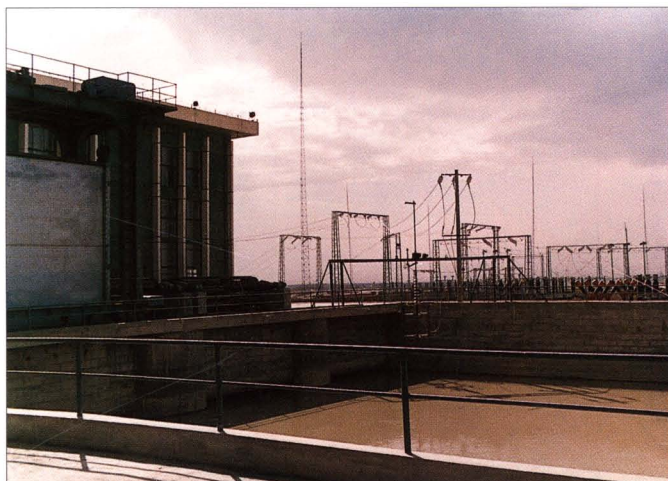
西大桥水电站
